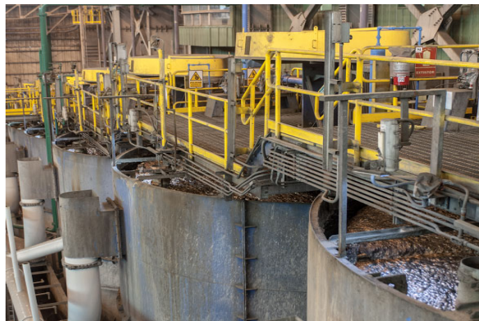
Figura 8. Celdas de flotación industriales.
